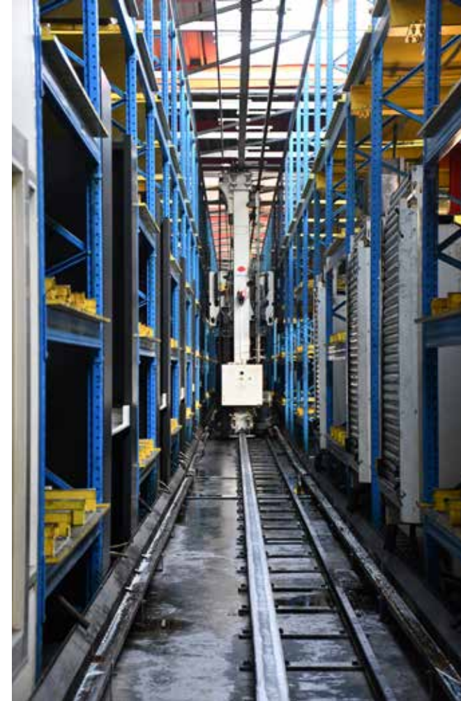
Het hart van het FMS-systeem bij Schramme is de portaalrobot. Hij is de orkestmeester die het samenspel tussen grondstoffen, gereedschappen en bewerkingen dirigeert.
